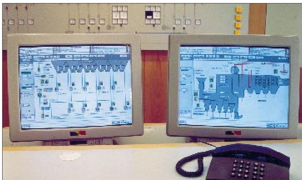
Müllverbrennungsanlage / Waste Incineration Plant
