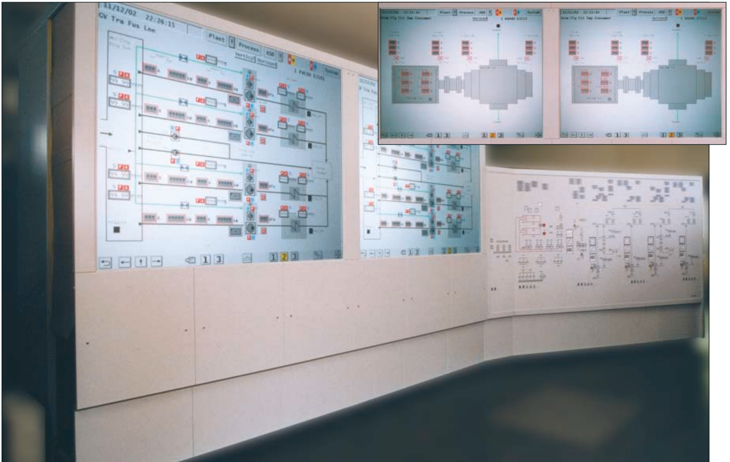
Kraftwerkswarte mit Großbildrückprojektion 90" / Power Plant Control Room with large screen rear projection 90"
